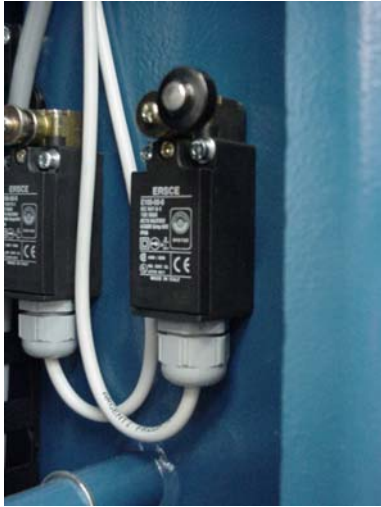
Figura 4: ¿Están funcionando correctamente los interruptores limitadores del carro portabobinas?
